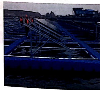
b. 水面漂浮电站
